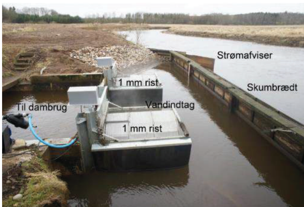
Figur 34 Indløbsbygværk ved Sig Fiskeri i Varde Å (foto: Jan Nielsen, DTU Aqua /11/).
