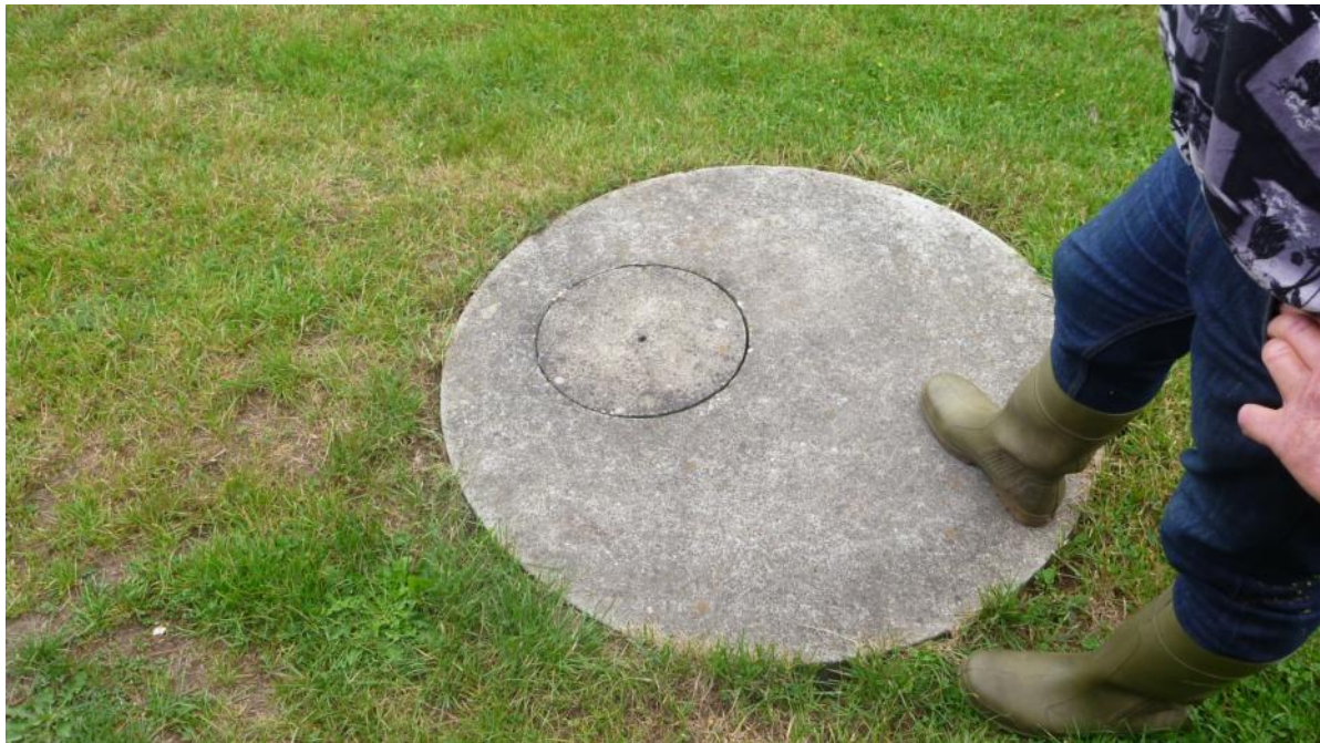
Foto 5 Afløb fra beboelsejendom ved Grene Fiskeri er samlet i brønd med afløb til Sønderbæk
